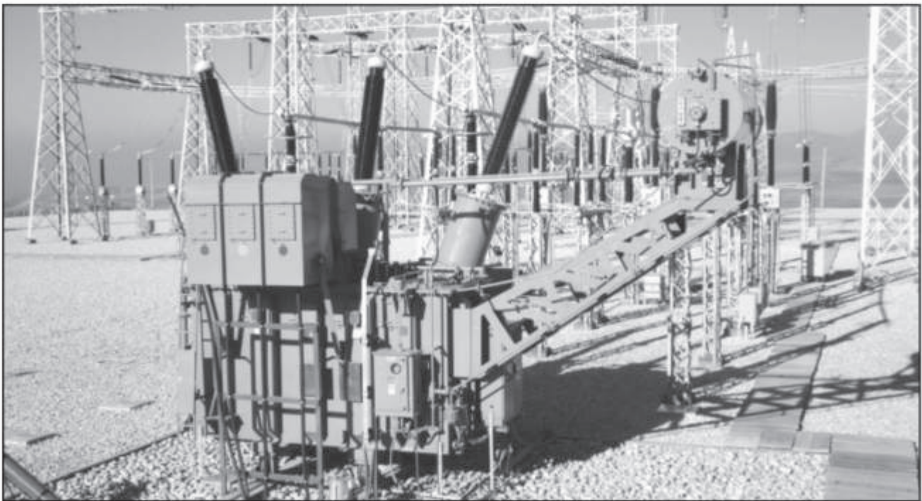
अयबक सब स्टेशन, अफगानिस्तान में 16 एम वी ए पावर ट्रांसफोर्मर
